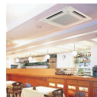
空調・冷熱システム
